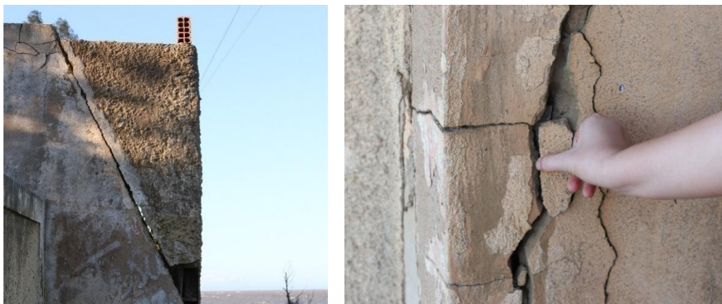
Figura 46: Imagens de rachaduras. Fonte: a autora Data: 2024
